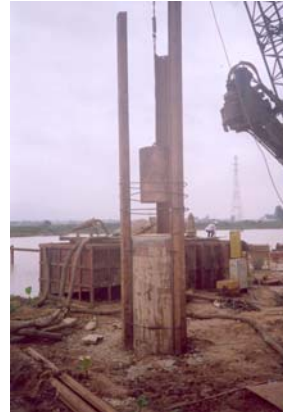
Hình 5. Đoạn bê tông cọc kéo dài phía trên mặt đất để phục vụ công tác thử động biến dạng lớn (PDA) tại cầu Đá Vách
